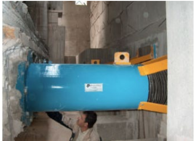
Figura 14 – Dissipadores viscosos de compressão OTP 400/600 na ponte de Rion-Antirion, Grécia [4]
