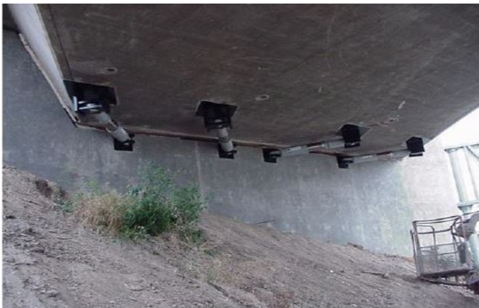
Figura 15 - Dissipadores viscosos na ponte de Orange County, Estados Unidos [18]
